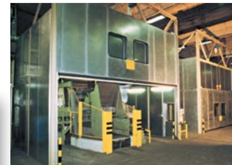
Encoffrement d'une grenailleuse ; Affaiblissement acoustique 25 dB ; Georg Fischer, D-Singen
