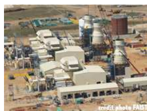
bâtiments insonorisants pour turbines à gaz (3 unités outdoor)
