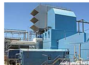
système d'admission d'air d'une turbine à gaz
