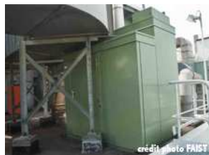
encoffrement d'un ventilateur (industrie chimique)
