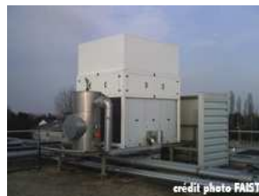
système de refoulement d'air insonorisé pour un aérocondenseur (industrie pharmaceutique)
