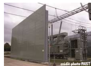
écran acoustique pour un transformateur
