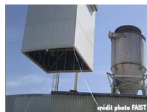
système de refoulement d'air insonorisé pour un cyclone: en cours de grutage (industrie du carton)
