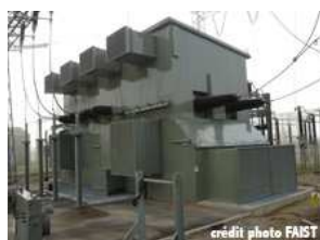
encoffrement d'un transformateur
